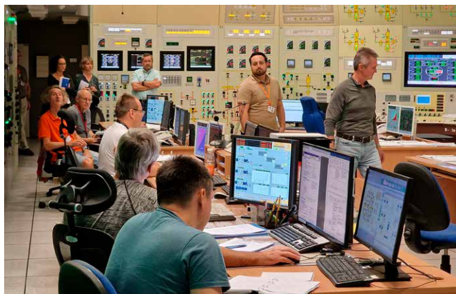
Na blokové dozorně
